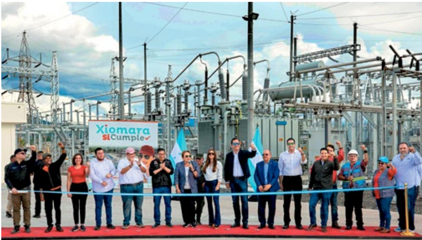
La Presidenta Xiomara Castro inauguró seis subestaciones eléctricas: Miraflores, Laínez, San Buenaventura, Bellavista, El Centro y San Pedro Sula Sur, además se retoma el control de la central hidroeléctrica Patuca III.
